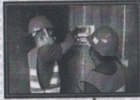
● งานไฟฟ้าเบื้องต้น
